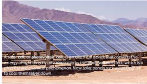
شانه ي خور (Solar cells Array ( Solar Panel)
